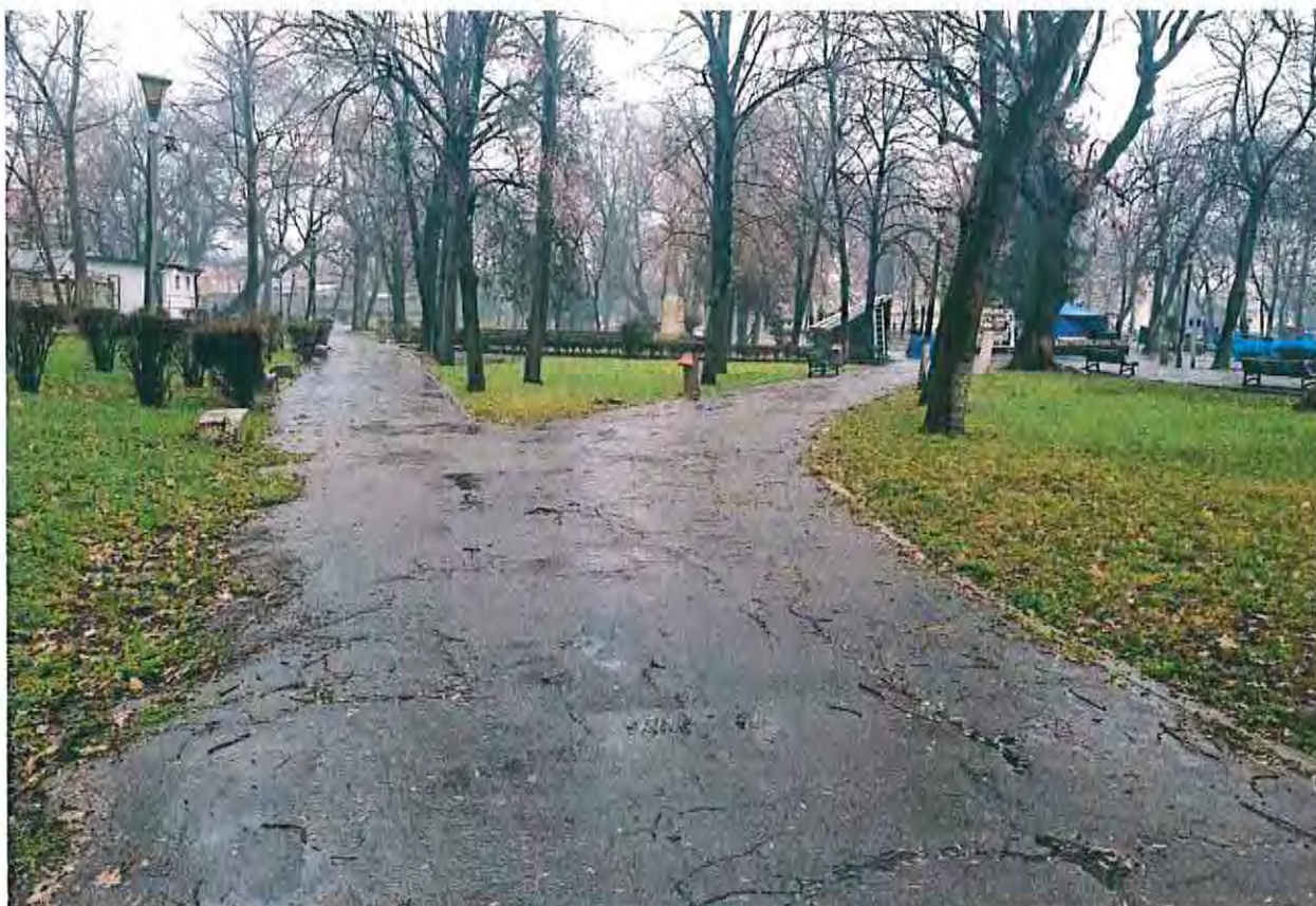
Stare generala asfalt degradata -faiantări, scurgere deficitara ape meteorice, lipsa borduri, vegetatie in crapaturi
