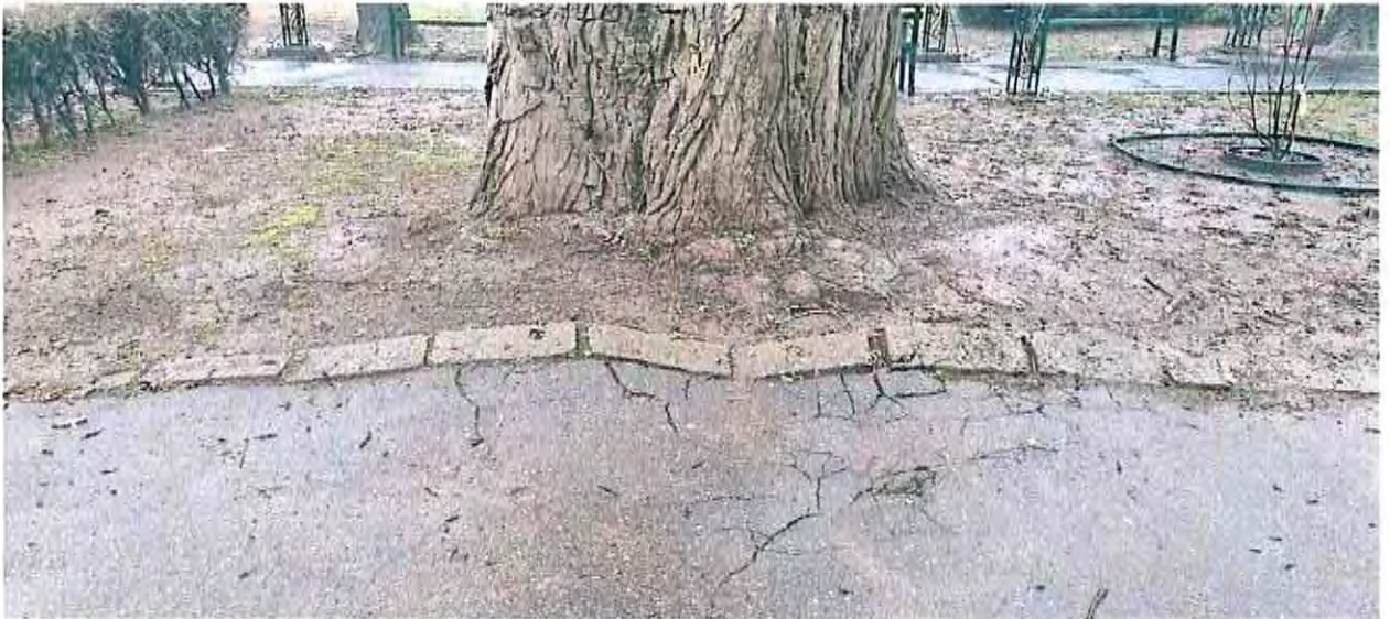
Stare generala asfalt degradata –
