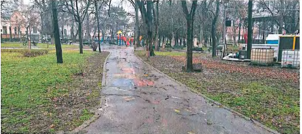
Stare generala asfalt degradata-faianțări, scurgere deficitara ape meteorice, plombe,
