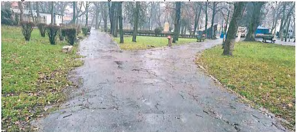
Stare generala asfalt degradata -faiantări, scurgere deficitara ape meteorice, lipsa borduri, vegetatie in crapaturi
