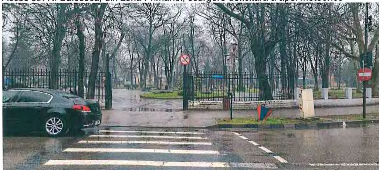
Acces de pe str. N. Bălcescu, din zona Primăriei, acces pentru care nu este asigurata scurgerea apei meteorice
