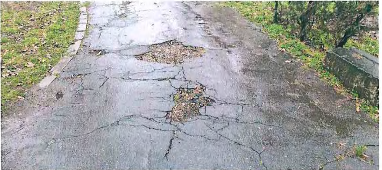
Stare generala asfalt degradata -gropi
