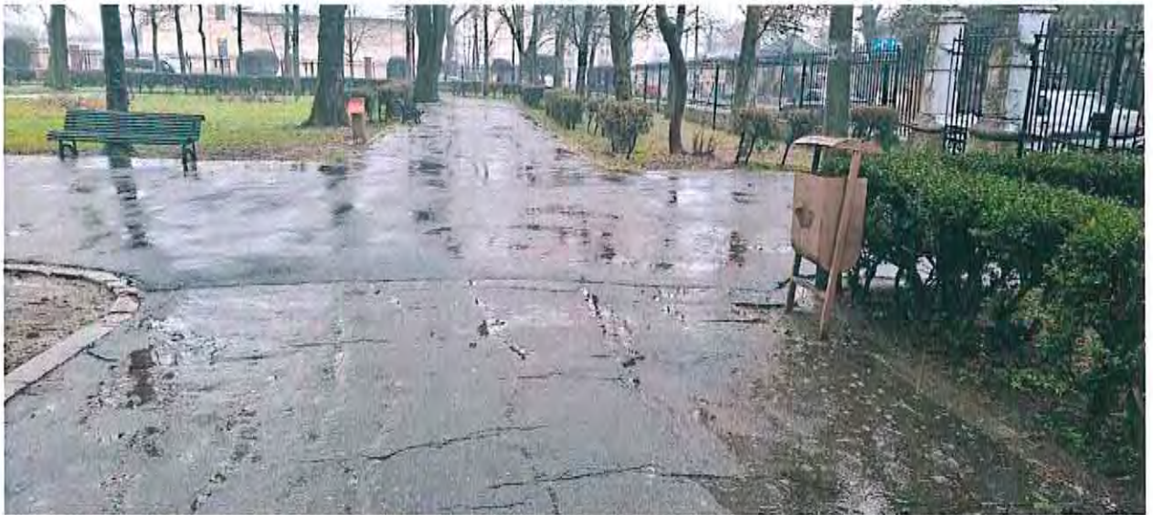
Stare generala asfalt- buna si degradata, intersectie alee principala cu alee secundara
