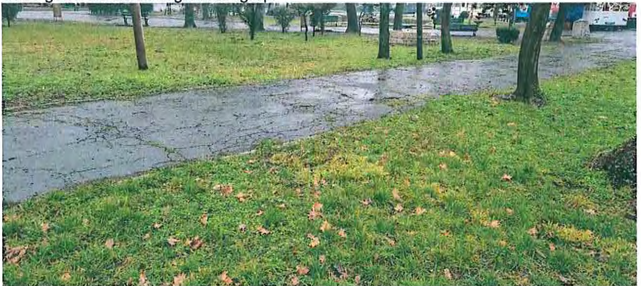
Stare generala asfalt degradata -faiantări,
