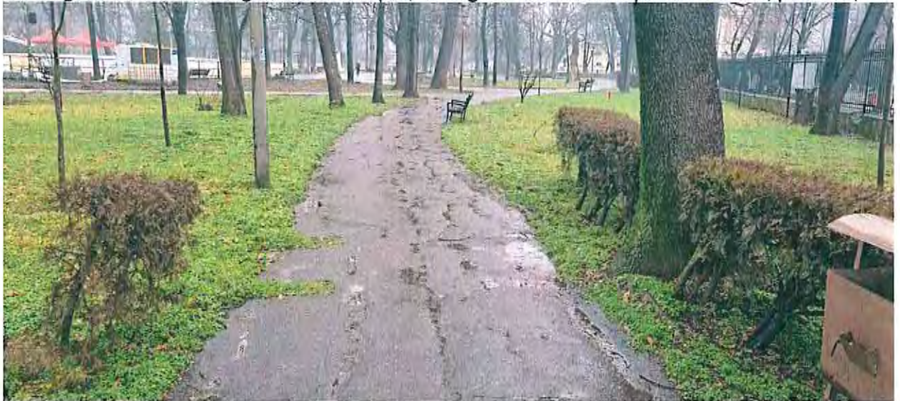
Stare generala asfalt degradata -faiantări, scurgere deficitara ape meteorice, lipsa borduri de încadrare
