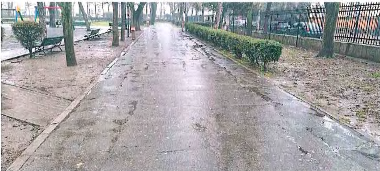
Stare generala asfalt degradata -faiantări,
