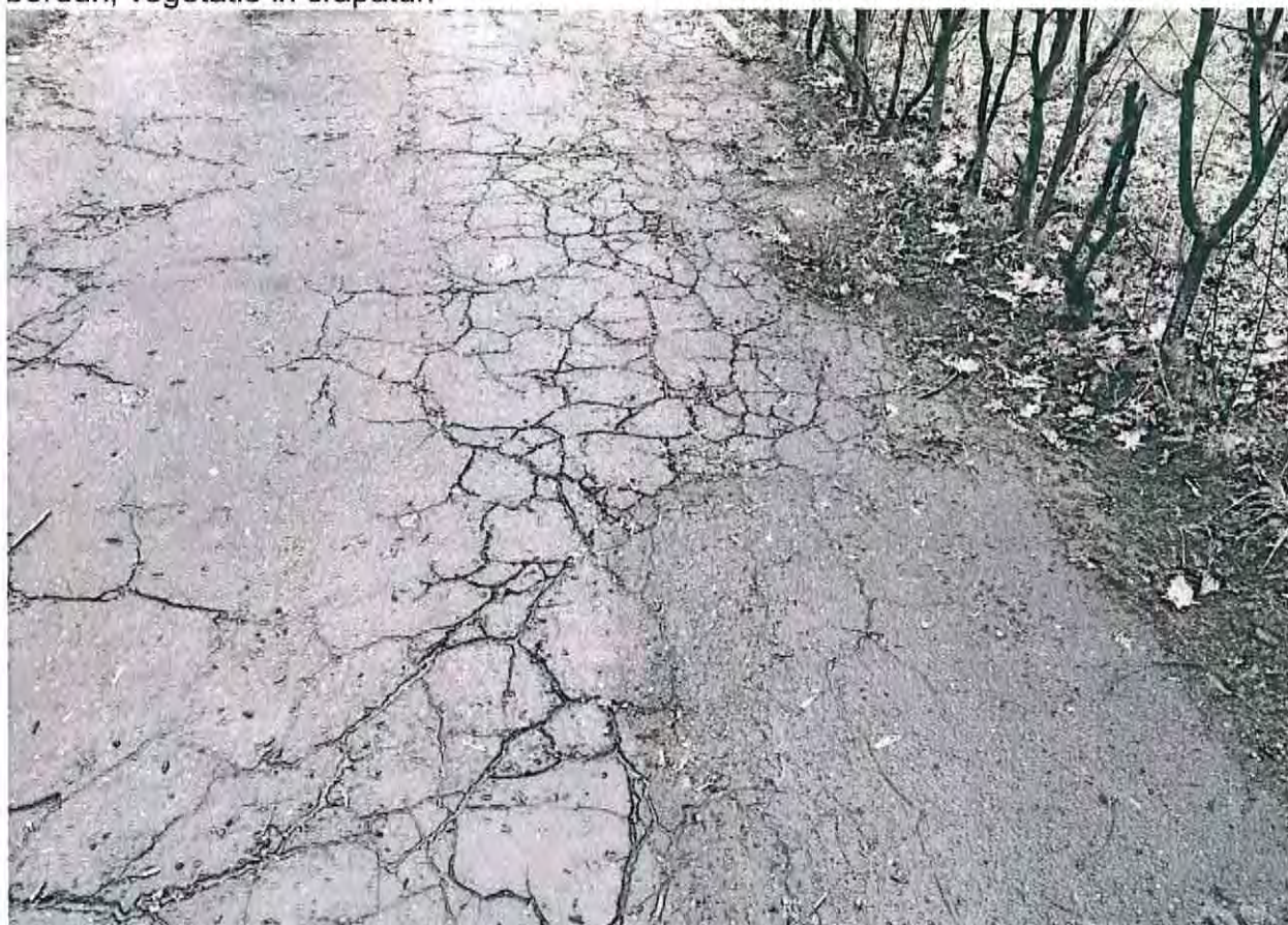
Stare generala asfalt degradata -faiantări,
