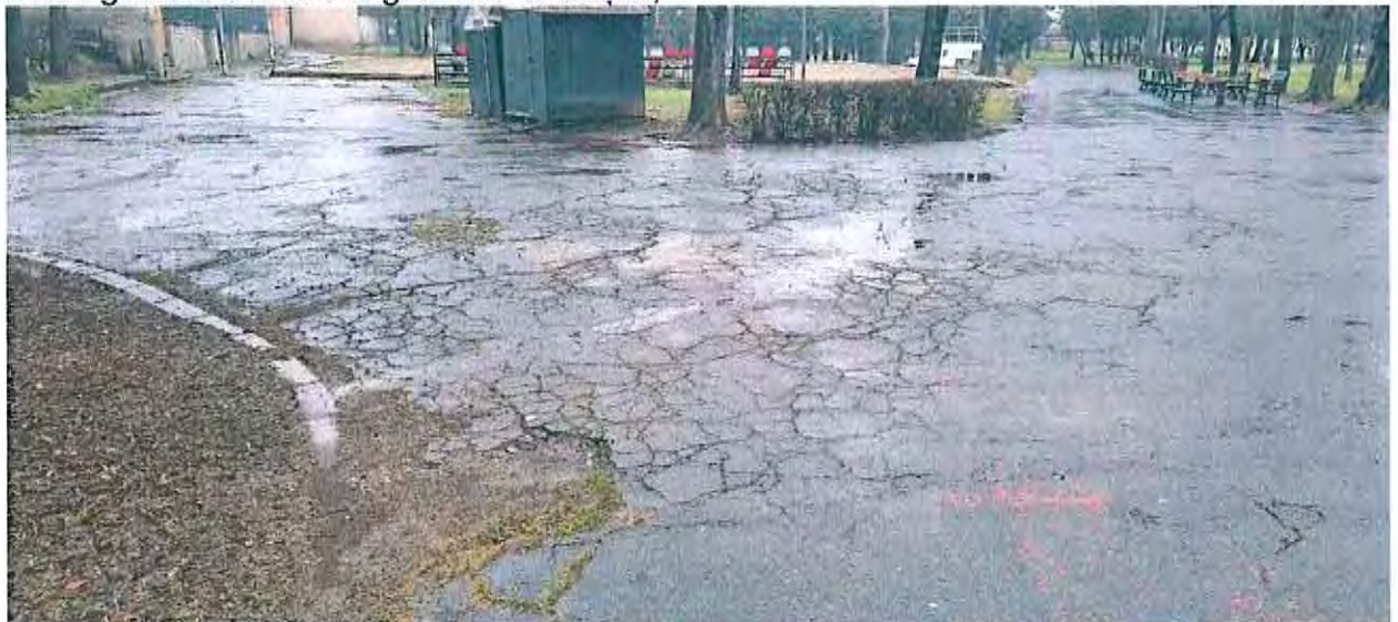
Stare generala asfalt degradata -faiantări,
