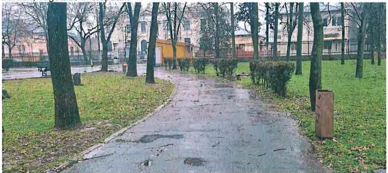
Stare generala asfalt degradata -faiantări,
