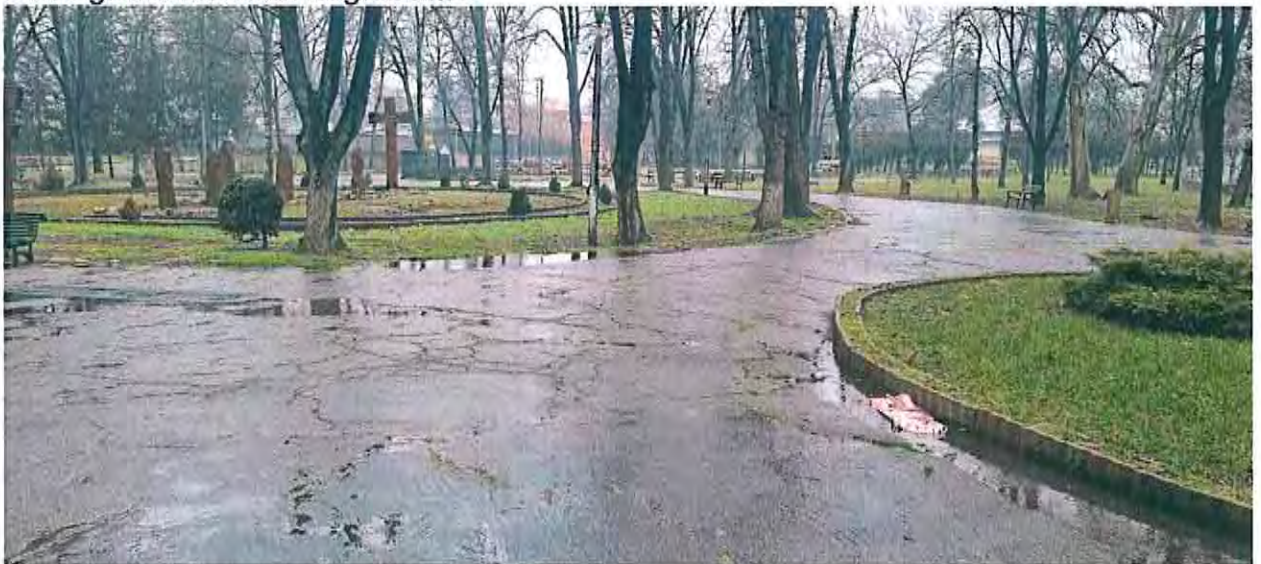
Stare generala asfalt degradata -faiantări,
