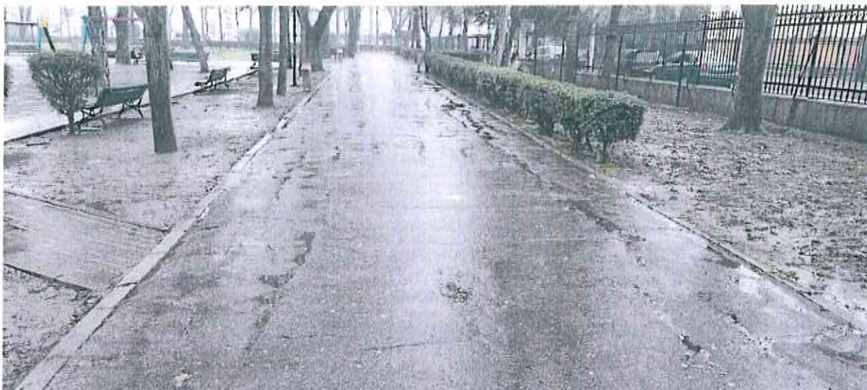
Stare generala asfalt degradata -faiantări,
