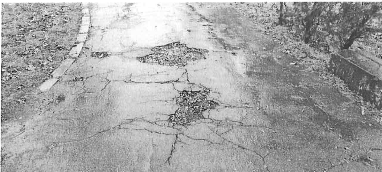
Stare generala asfalt degradata -gropi
