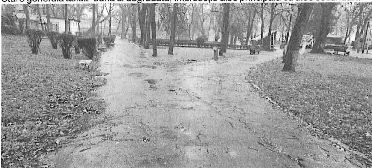
Stare generala asfalt degradata -faiantări, scurgere deficitara ape meteorice, lipsa borduri, vegetatie in crapaturi
