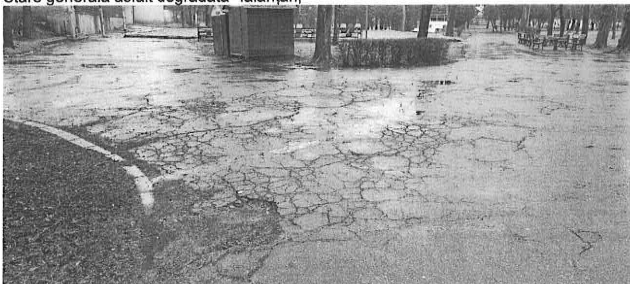
Stare generala asfalt degradata -faiantări,
