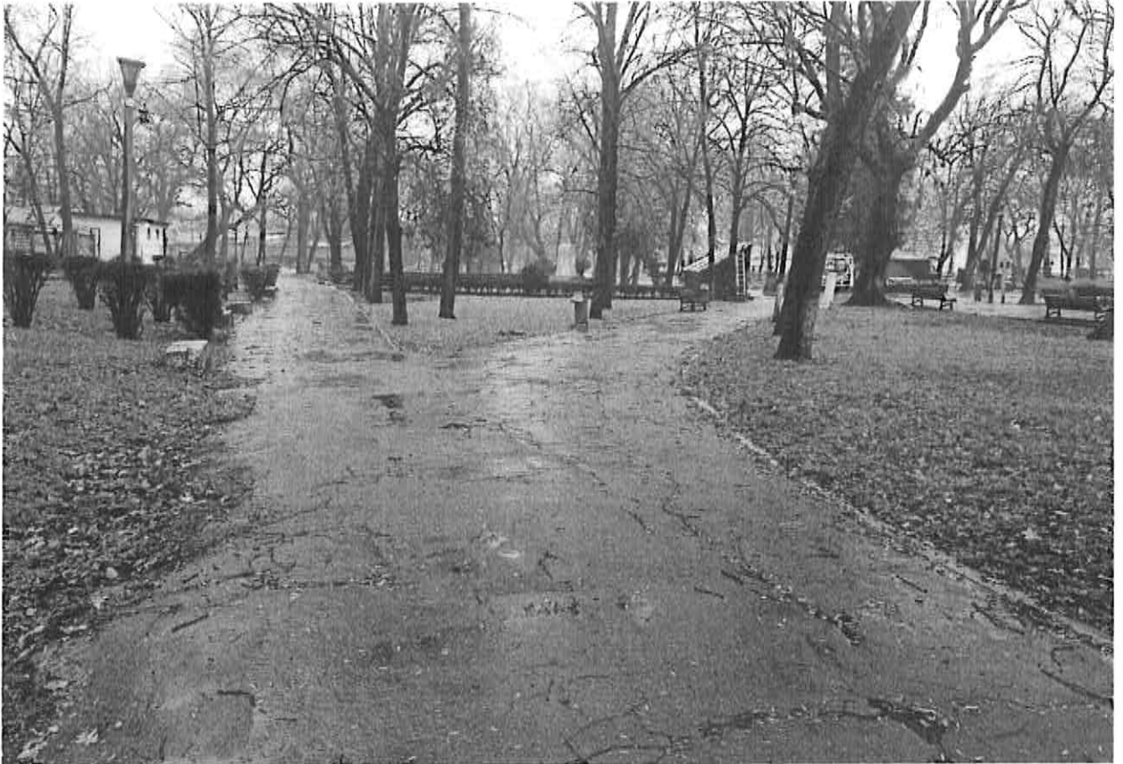
Stare generala asfalt degradata -faianțări, scurgere deficitara ape meteorice, lipsa borduri, vegetatie in crapaturi
