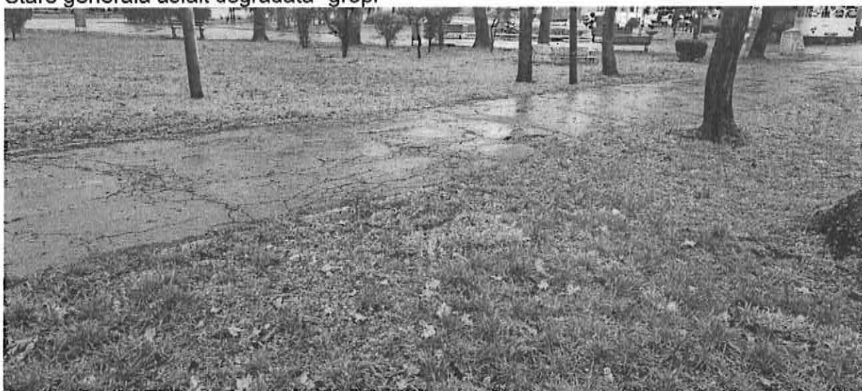
Stare generala asfalt degradata -faiantări,
