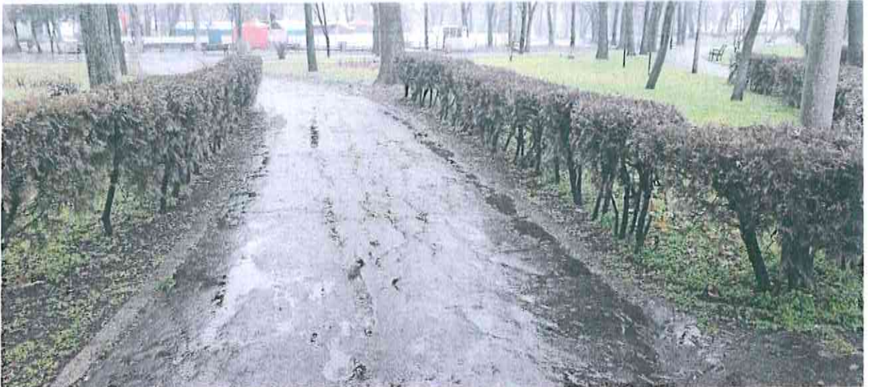
Stare generala asfalt degradata -faiantări, scurgere deficitara ape meteorice,
