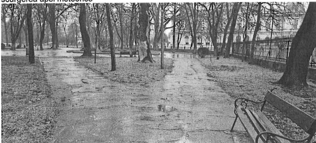
Stare generala asfalt degradata -faiantari, scurgere deficitara ape meteorice, lipsa borduri de incadrare
