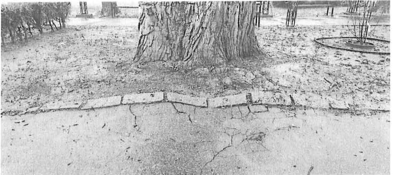
Stare generala asfalt degradata –
