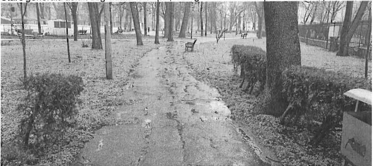
Stare generala asfalt degradata -faiantări, scurgere deficitara ape meteorice, lipsa borduri de încadrare
