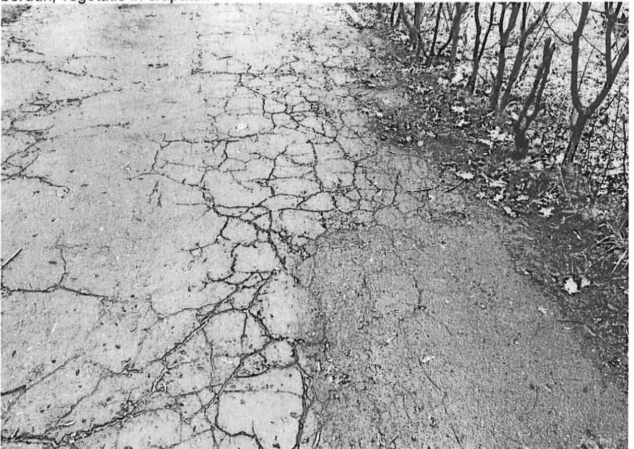
Stare generala asfalt degradata -faianțări,
