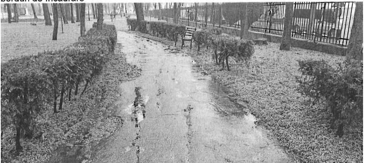
Stare generala asfalt degradata -gropi, cedări de margine
