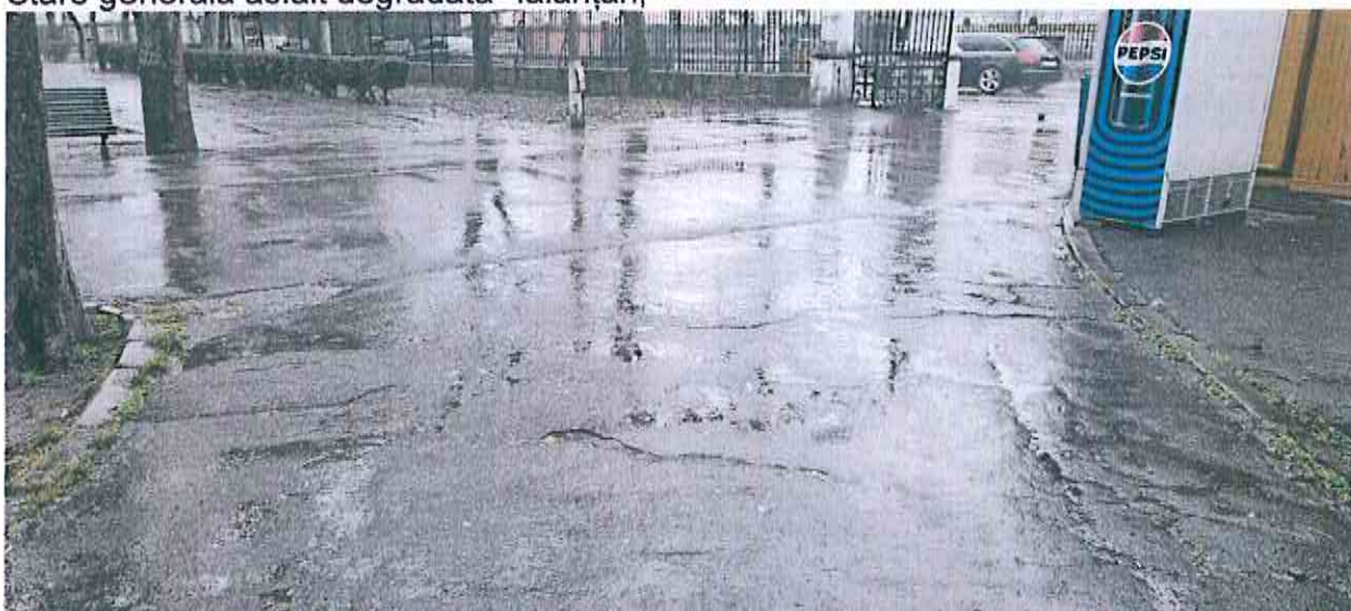
Stare generala asfalt- buna si degradata, intersectie alee principala cu alee secundara
