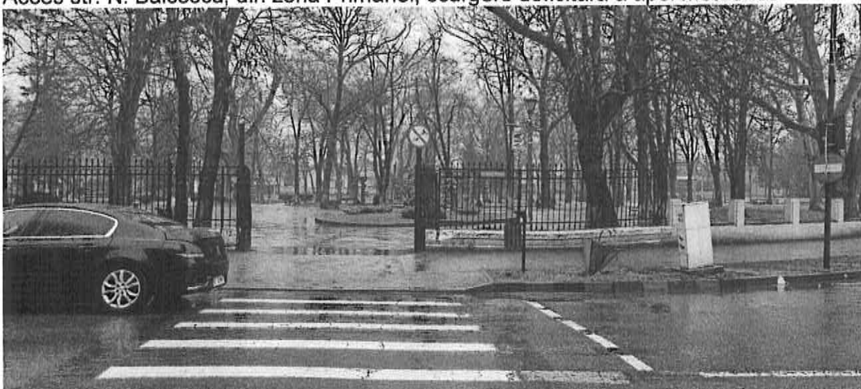
Acces de pe str. N. Bălcescu, din zona Primăriei, acces pentru care nu este asigurata scurgerea apei meteorice
