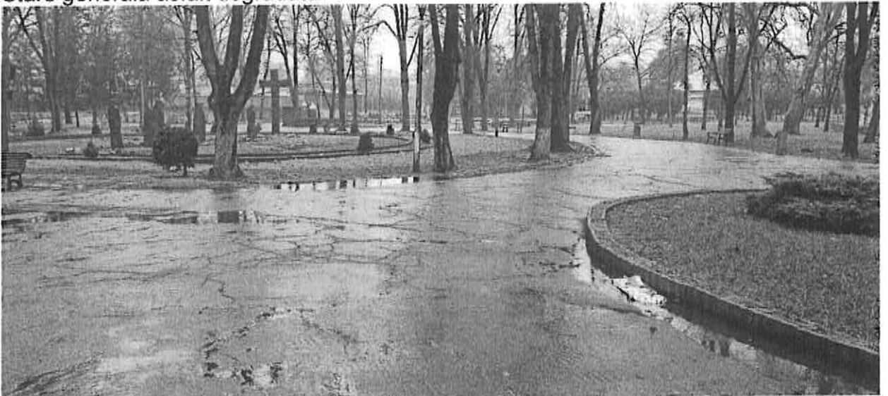
Stare generala asfalt degradata -faiantări,
