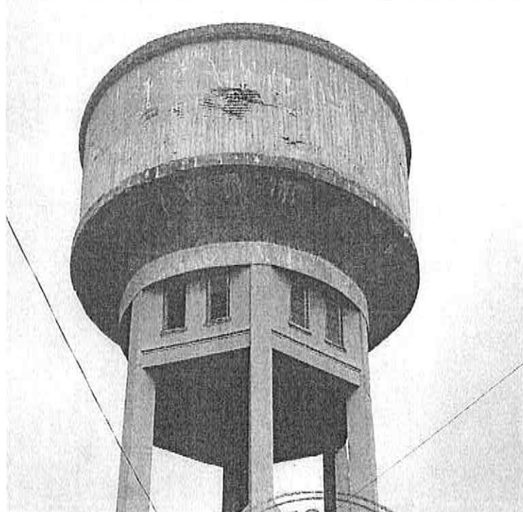
Foto 6 – Armături aparente în structura rezervoarului din beton armat
